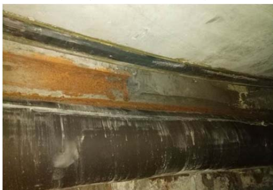
图2 盾构机掘进 2000m 后气囊磨损情况
