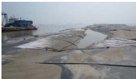
图1 水域管袋围堰塌陷
